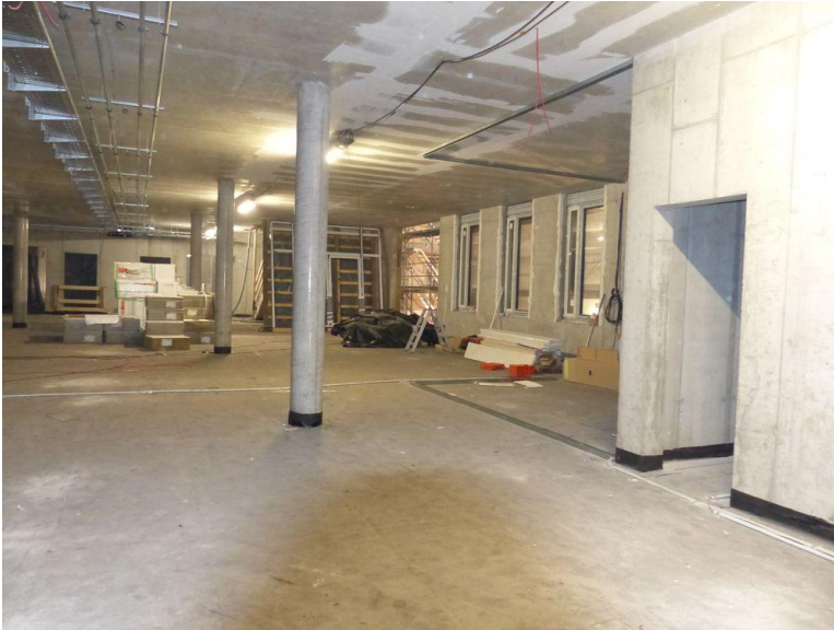
Hier ein Blick in den künftigen Empfangsbereich für Besucher. Der Haupteingang liegt in südlicher Richtung, von hier blickt man direkt in das Stadtzentrum von Haldensleben. Foto Uwe Baumgart
